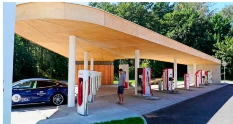
Luxus-Laden: An dieser Station in Tschechien zwischen Brünn und Prag gab es Stationen mit fast allen gängigen Ladesystemen. Rieger: »Vorbildlich und nachahmenswert.«
